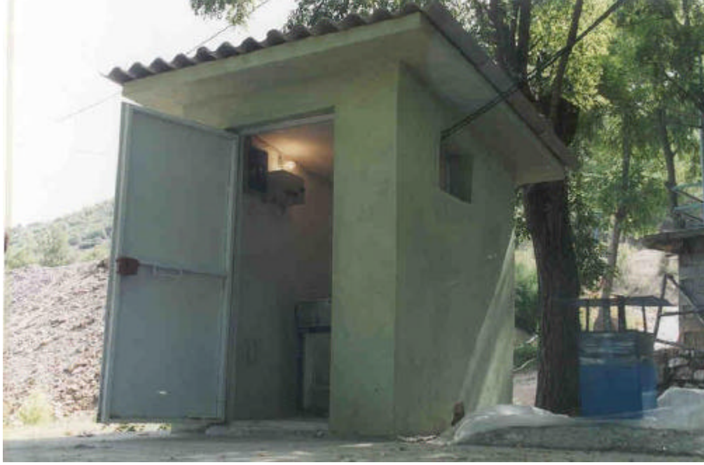
Sekil 16. “Deprem Erken Uyarı Sistemi” Sifa (Burdur) ölçüm istasyonu
